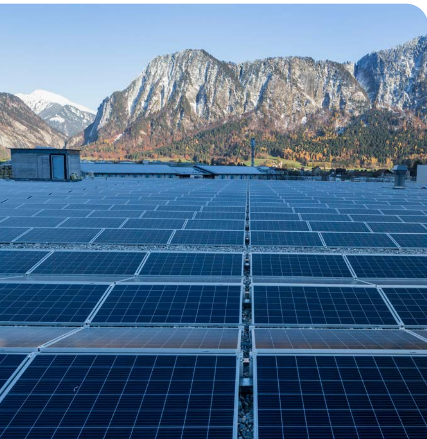
↑ PV-Anlage der tritec in Landquart GR
